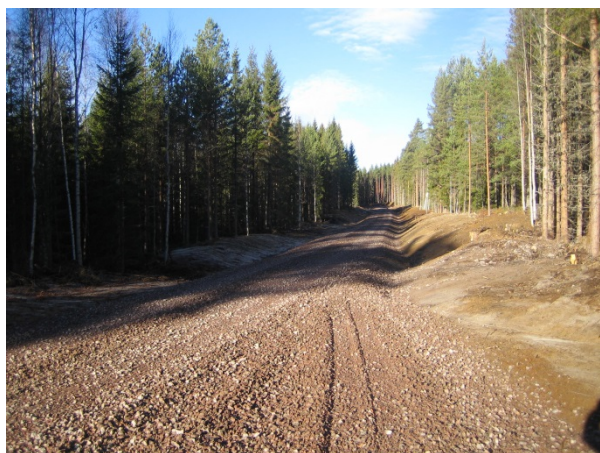
Opprustet «Torpevegen» i Flobergsetra utført 2018
