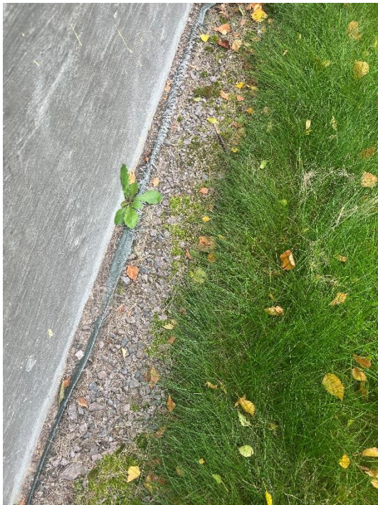
Bilde 3 Presenning istedenfor grunnmurspapp i hjørnet mot sør-vest.
