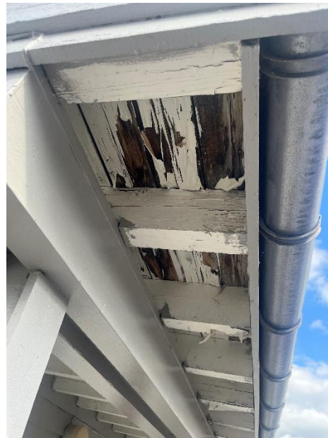
Bilde 32 Råte i takstikk/raft.
