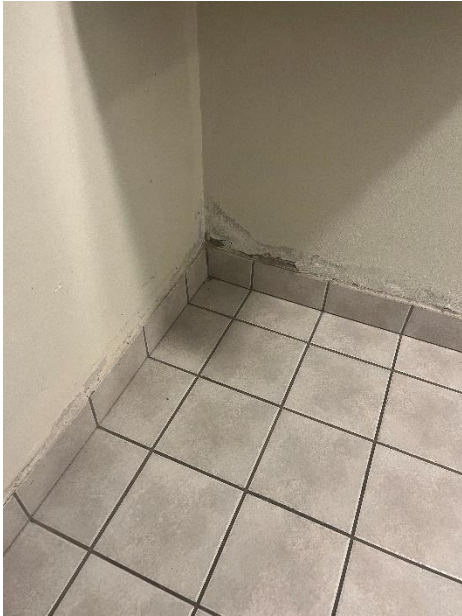
Bilde 23 Antydning til fukt i kjelleryttervegg.
