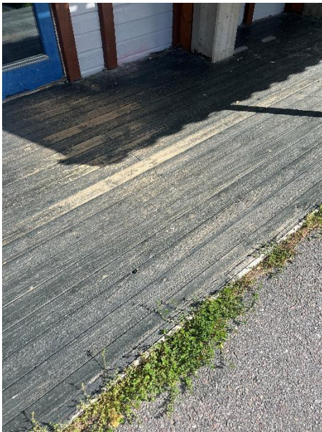
Bilde 37 Utvendig platting, mangelfullt vedlikeholdt.
