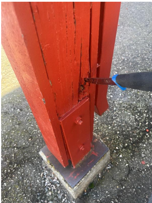
Bilde 5 Råte i utvendige søyler av tre ved inngangsparti.
