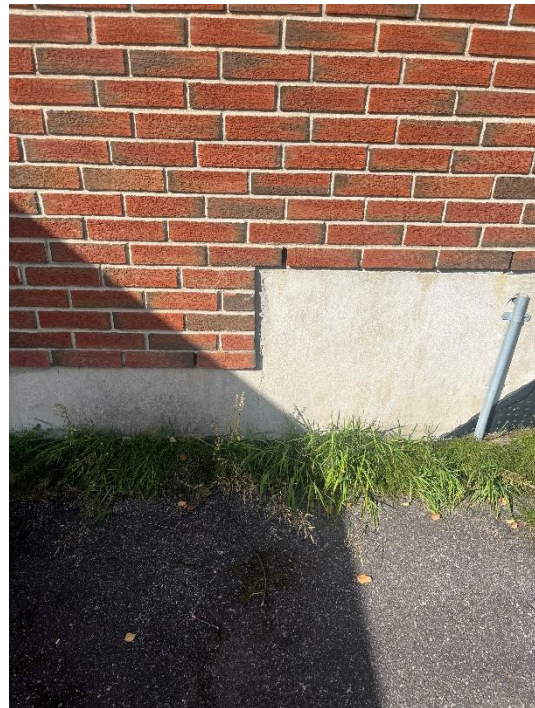
Bilde 2 Riss i grunnmur på påbygg fra 1983.
