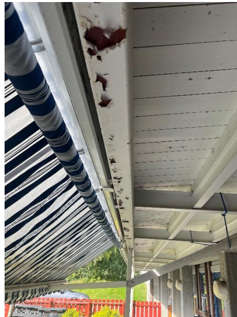
Bilde 16 Omfattende malingsavflassing på ståldrager under takutstikk.
