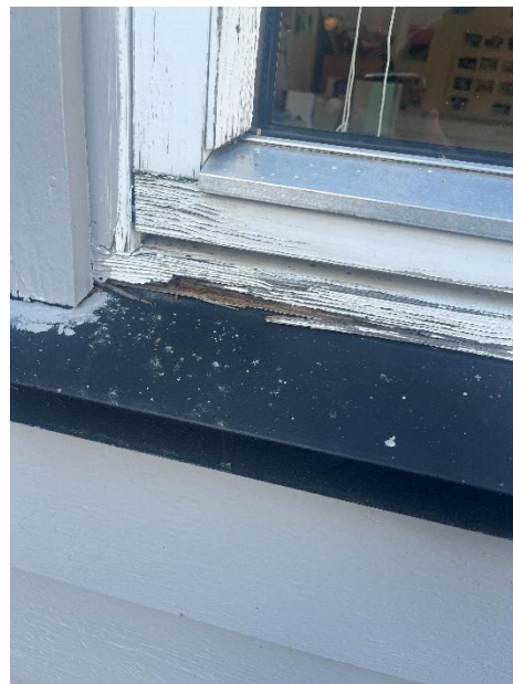
Bilde 10 Råte i bunnkarm.
