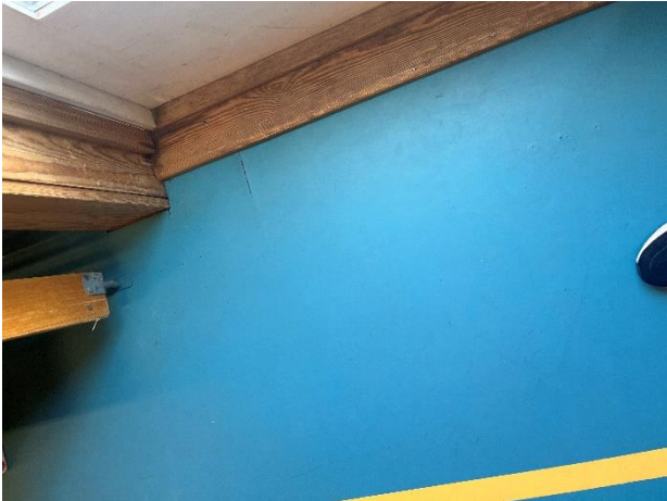
Bilde 19 Oppsprekking sportsgulv.
