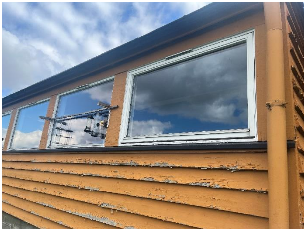
Bilde 7 Svært malingsslitt panel som bærerpreg av manglende vedlikehold over tid.
