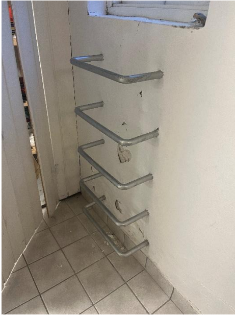
Bilde 35 Stige, rømning gjennom vindu i kjeller, noe saltutslag på yttervegg
