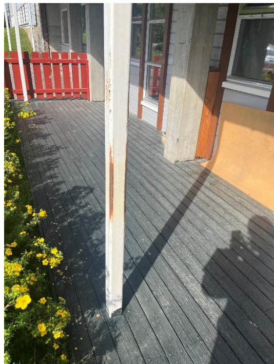
Bilde 6 Korrosjon på stålsøyler
