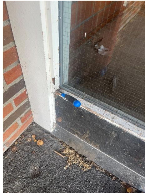
Bilde 14 Råte ytterdør.
