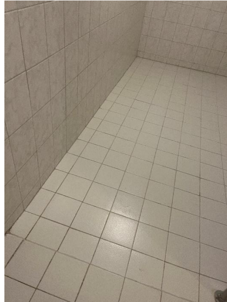
Bilde 24 Fliser i dusjrom i kjeller, slitasje.
