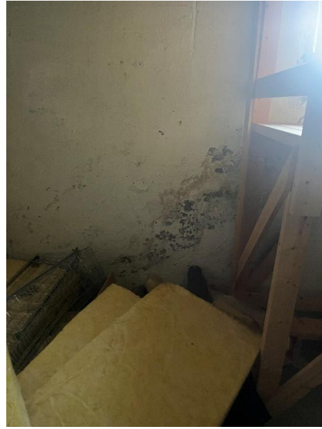
Bilde 36 Saltutslag innside kjellervegg.
