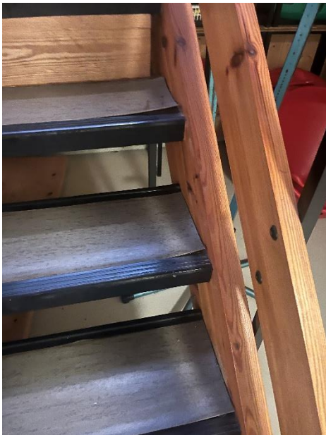
Bilde 25 Løst gulvbelegg i trapp.
