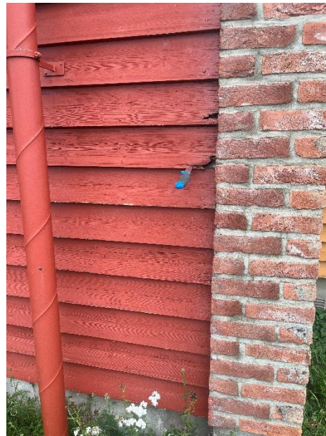
Bilde 8 Råteskadet panel.
