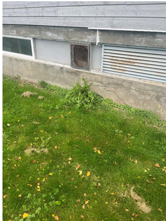
Bilde 4 Riss og oppsprekking grunnmur mot vest.
