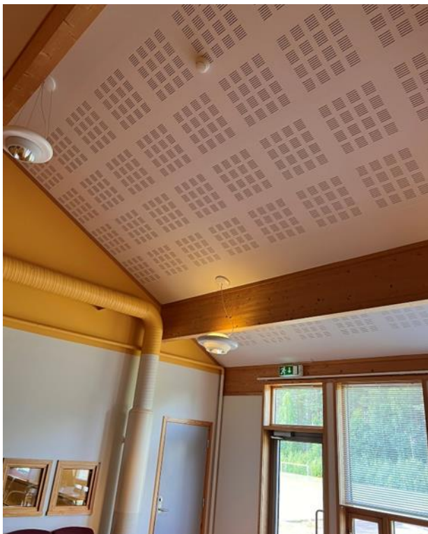
Bilde 17 Himling og vegger bygg N. Kilde: Bilde tatt ved befaring 02.09.2024.
