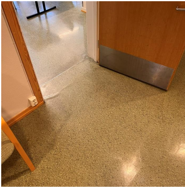
Bilde 19 Banebelegg på gulv i bygg H. Kilde: Bilde tatt ved befaring 02.09.2024.
