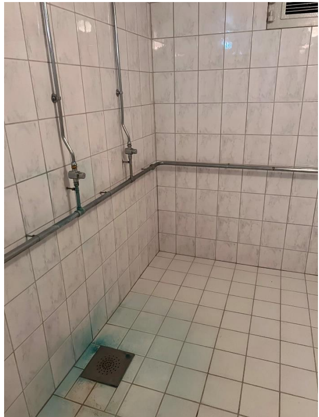
Bilde 12 Fellesdusjer i underetasje bygg G. Kilde: Bilde tatt ved befaring 02.09.2024.
