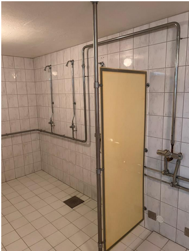
Bilde 11 Fellesdusjer i underetasje bygg G. Kilde: Bilde tatt ved befaring 02.09.2024.
