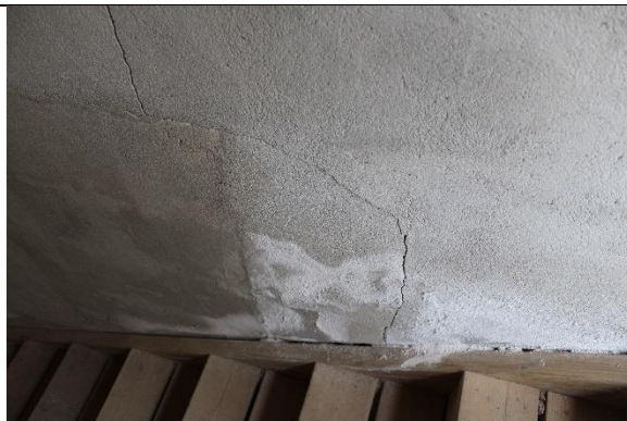
Bilde 01: Oppsprekking i murvegg i kjellernedgang.
