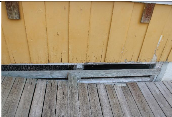
Bilde 02: Oppsprekking på fasade mot sør.
