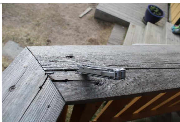
Bilde 05: Råte i toppbord på rekkverk.
