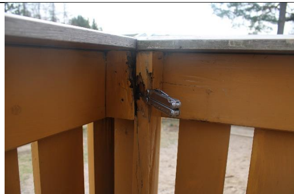
Bilde 03: Råte i stolpe på rekkverk.
