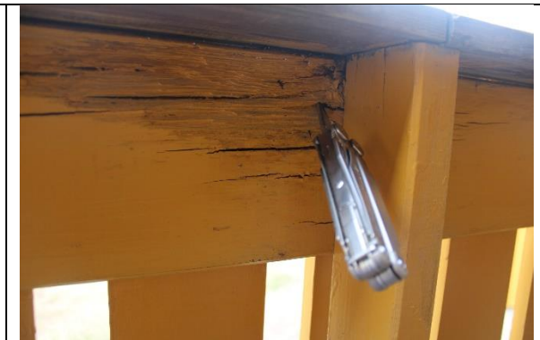
Bilde 04: Råte i spikerslag på rekkverk.
