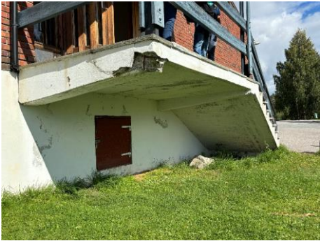
Nedre bygg: Betongskade på utkraget trapperepos må repareres. Øvre håndløper på trapp skiftes
