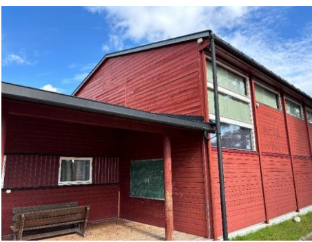
Øvre bygg, gymsal: Gavl mot vest anbefales kledd om. Langfasade mot syd samt liten gavl mot øst bør rengjøres og beises
