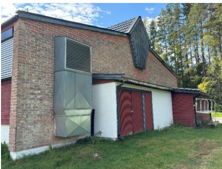
Øvre bygg: Skadde takrenner mot nord må skiftes
