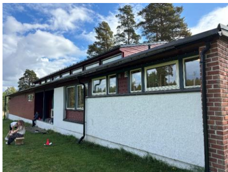
Øvre bygg, mellombygg: Skadet takrenne mot øst må skiftes
