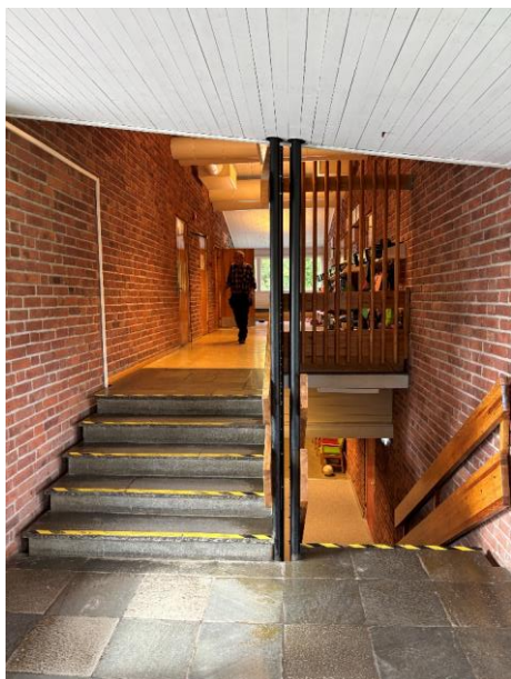
Øvre bygg: Skiferkledd trapp med slitt boning. Håndløpene ned fra øvre plan har omfattende slitasjeskader.
