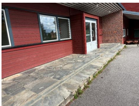
Øvre bygg: Forkant på skifer skadet / avskallet
