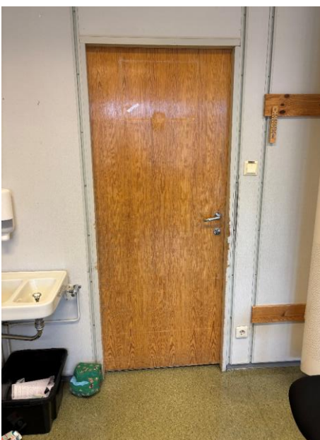
Nedre bygg: Omfattende slitasje på klasseromsdør og karm/gerikter
