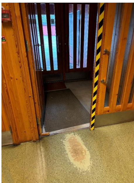
Nedre bygg: Del av gulvbelegg med omfattende slitasje, ellers jevn slitasje
